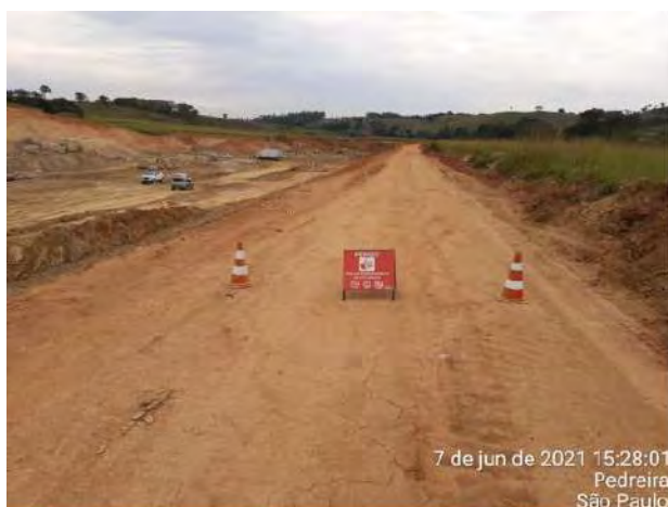
Foto 177 – Bloqueio de acesso. (Data:07/06/2021)
