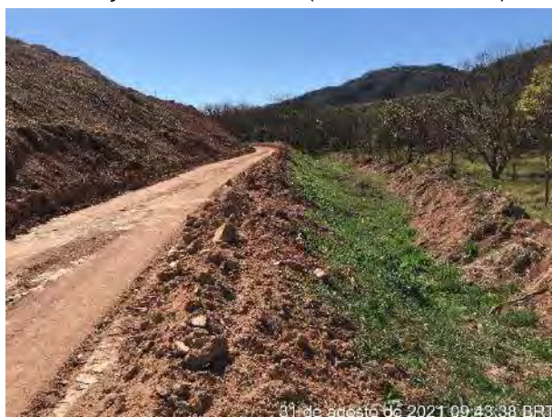
Foto 249 – Leira e canaletão para retenção de material e disciplinamento do fluxo para as caixas de retenção. (Data:31/08/2021)
