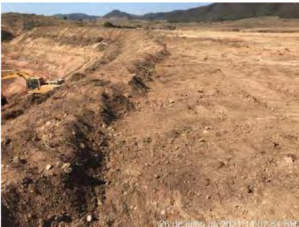
Foto 241 – Máquina aplicando solo vegetal. Vista para leiras com solo vegetal na crista do talude, platô do Bota Fora 01 (Data: 26/07/2021)
