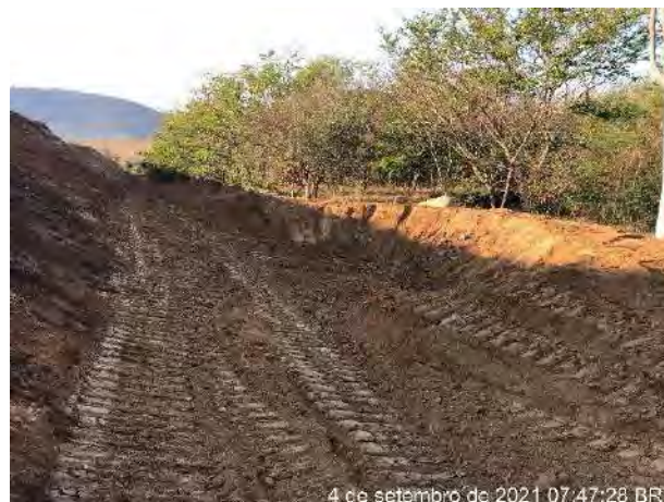
Foto 287 – Vista para a cacimba de retenção de sólidos. (Data: 04/09/2021)
