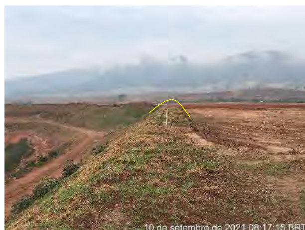
Foto 254 – Leira e canaletão para retenção de material e disciplinamento do fluxo para as caixas de retenção. (Data: 31/08/2021)
