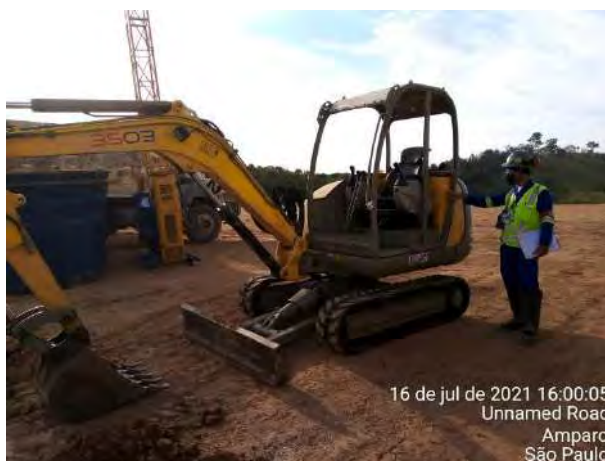
Foto 151 – Check list equipamento. (Data:16/07/2021)
