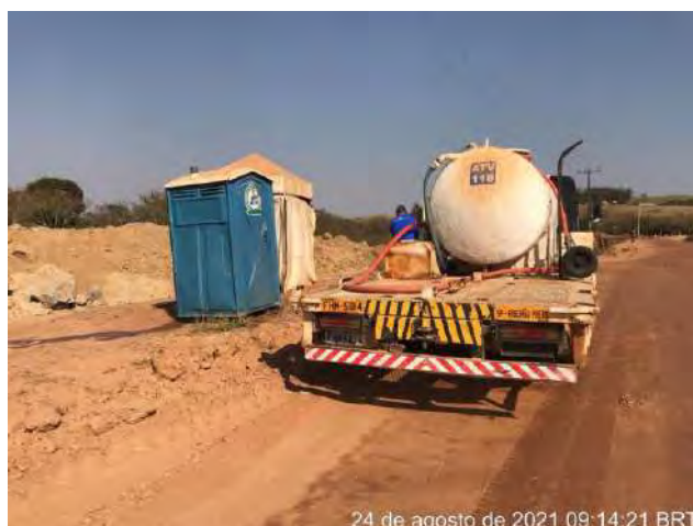
Foto 338 – Limpeza do banheiro químico. (Data: 24/08/2021)
