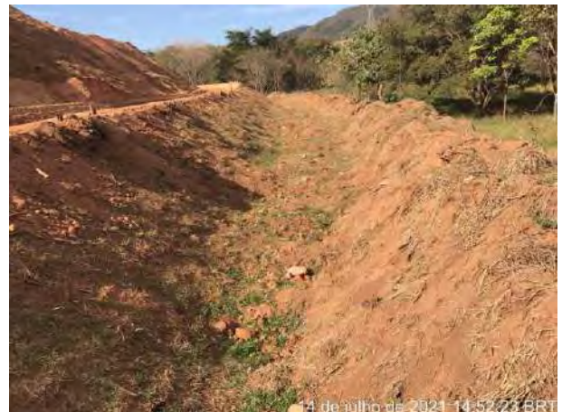
Foto 242 – Leira e canaletão para retenção de material e disciplinamento do fluxo para as caixas de retenção. (Data: 14/07/2021)
