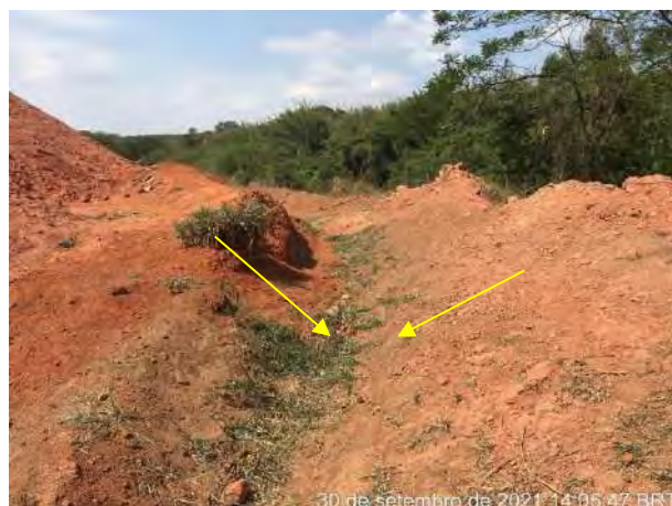
Foto 234 – Canaleta e leira no entorno da bota espera. (Data:30/09/2021)
