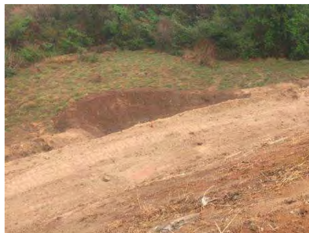
Foto 291 – Vista para cacimba de retenção de sólidos. (Data: 18/09/2021)
