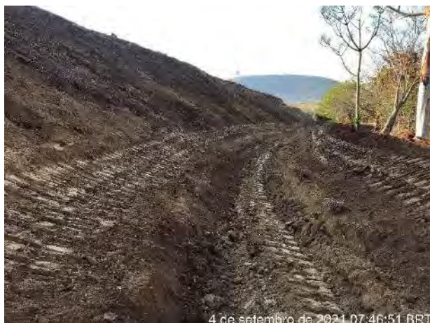
Foto 286 – Disciplinamento das águas pluviais. (04/09/2021).
