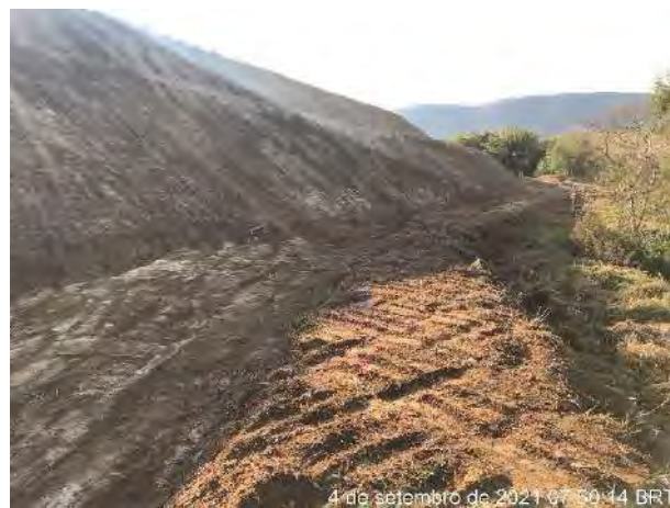
Foto 289 – Vista da leira no pé do talude e canaletão para direcionamento do fluxo de água. (Data: 04/09/2021)
