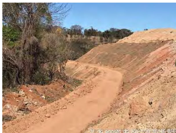
Foto 248 – Leira e canaletão para retenção de material e disciplinamento do fluxo para as caixas de retenção. (Data: 31/08/2021)
