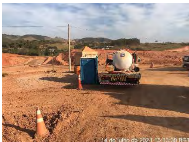
Foto 336 – Limpeza do banheiro químico. (Data: 14/07/2021)
