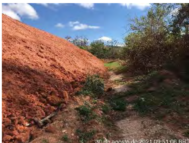
Foto 228 – Canaleta e leira no entorno da bota espera. (Data:30/08/2021)
