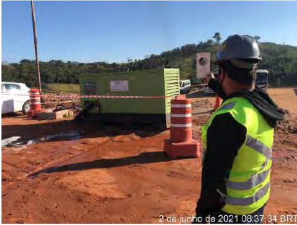
Foto 352 – Inspeção de fumaça preta do gerador. (Data:02/06/2021)
