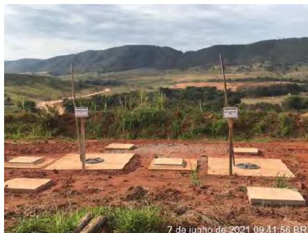
Foto 335 – Biodigestor instalado no canteiro industrial. (Data: 07/06/2021)
