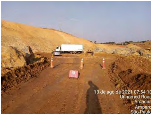
Foto 189 – Bloqueio de acesso. (Data:13/08/2021)
