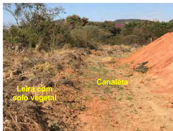
Foto 221 – Canaleta e leira no entorno da bota espera. (Data:27/07/2021)
