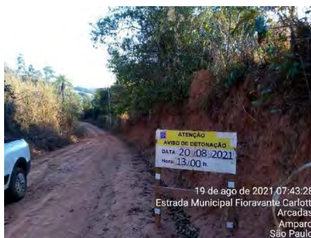
Foto 186 – Placa de aviso externo de detonação. (Data:19/08/2021)
