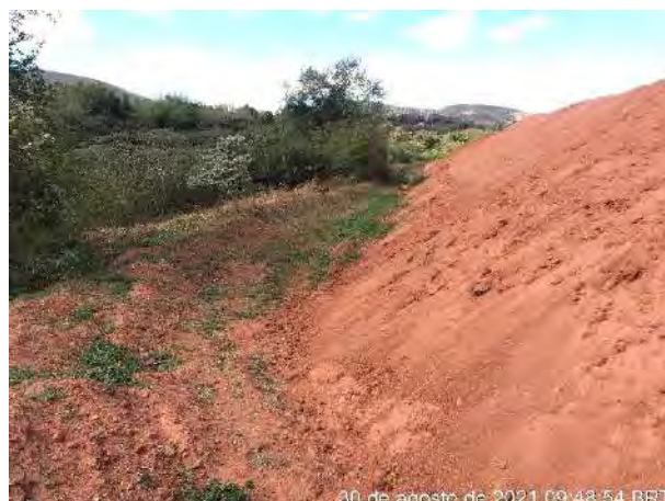
Foto 227 – Canaleta e leira no entorno da bota espera. (Data:30/08/2021)
