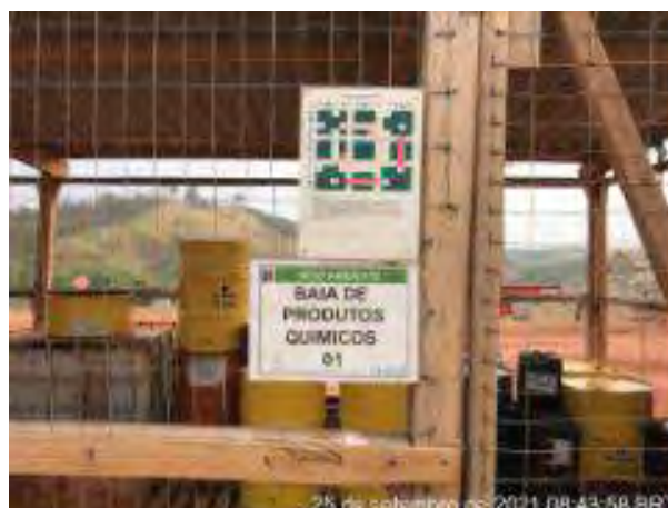
Foto 90 – Baia para armazenamento de produto químico. (Data:25/09/2021)
