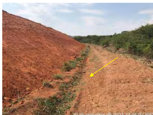
Foto 233 – Canaleta e leira no entorno da bota espera. (Data:30/09/2021)
