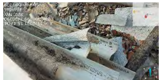
Foto 12. Telhas com amianto
